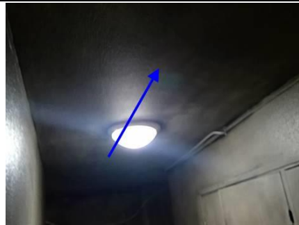
Photo n° PhA004 Localisation : Palier Ouvrage : 4 - Plafonds et faux plafonds - Plafonds Partie d'ouvrage : Enduit à base de plâtre lissé ou taloché Description : Enduit à base de plâtre lissé ou taloché
